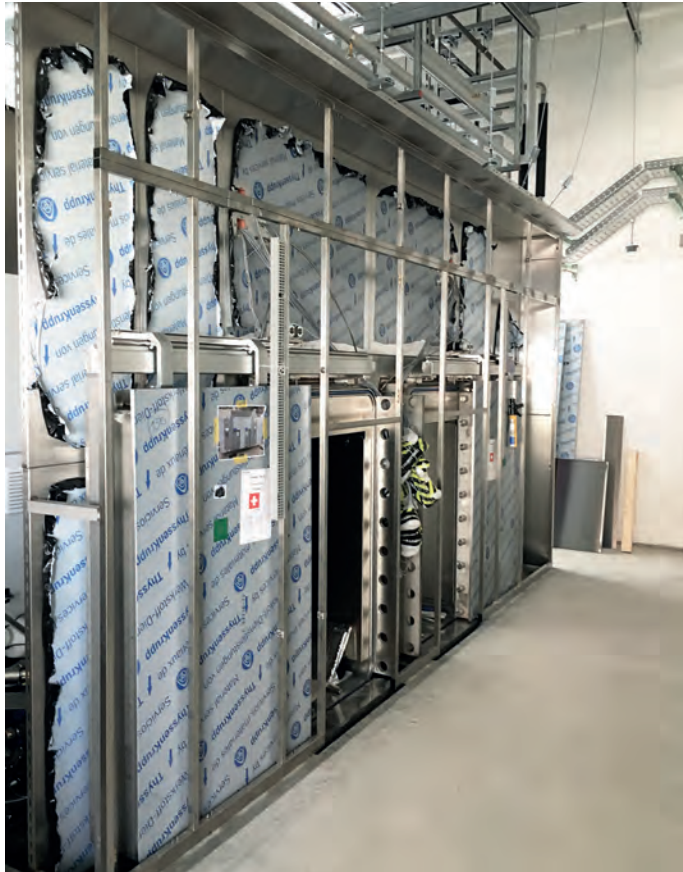
Aufbau der Geringe-Sterilisatoren während der Installationsphase. (Bild: Geringe Schweiz AG)
