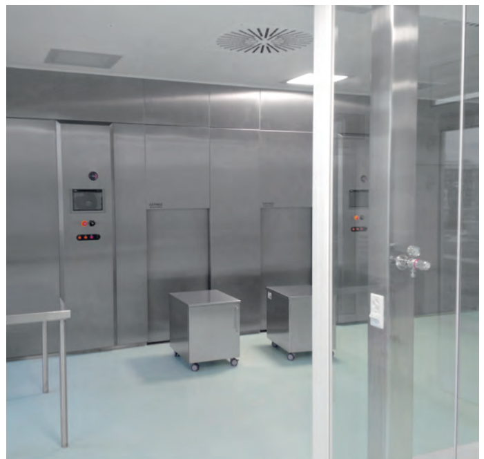
Fertige Installation der betriebsbereiten bodenebenen befahrbaren Sterilisatoren mit 1.350 l Kammervolumen. (Bild: Geringe Schweiz AG)
