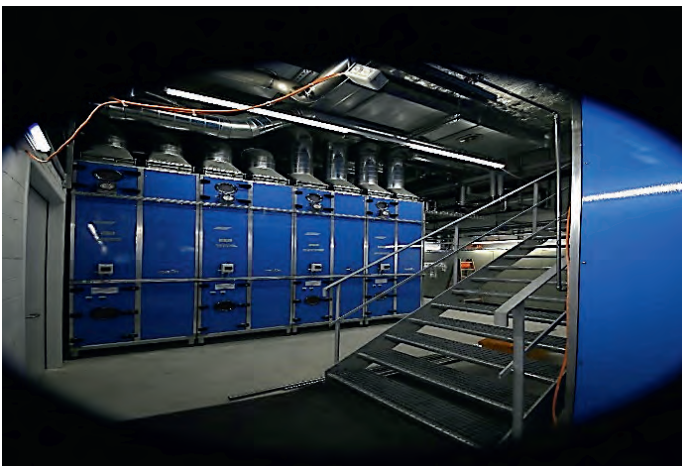
Umluftanlagen Reinnräume LK10 (Foto Bouygues)
