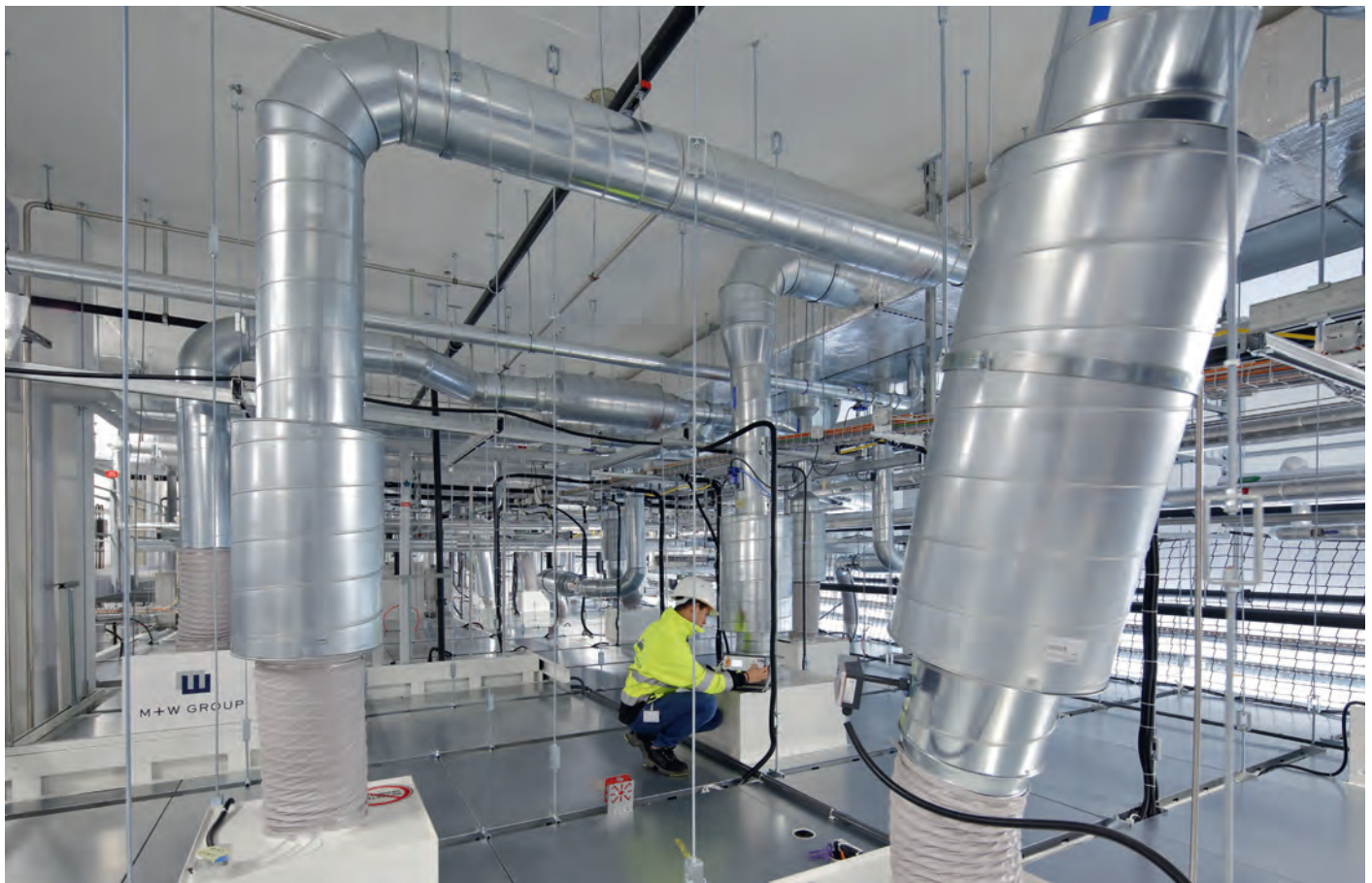
Abbildung 1: Technischer Zwischenboden mit Lüftung und Medienversorgung. Die gesamte Wartung wird sicher und ohne Störung des Fertigungsbetriebs über die begehbare Decke durchgeführt. Alle Systeme sind darauf ausgelegt, dass der Produktionsbereich bei Bedarf erweitert werden kann. (Foto Exyte)
