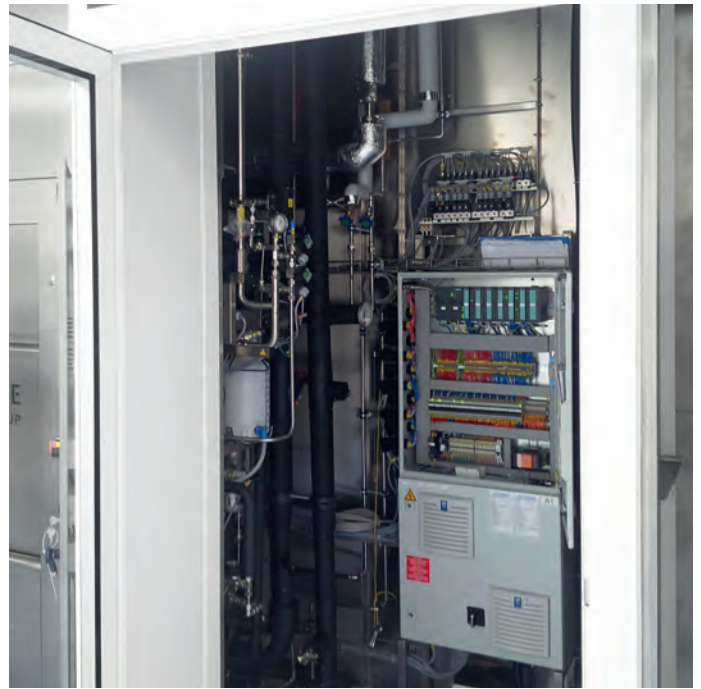
Technikzone der Sterilisatoren. (Bild: Geringe Schweiz AG)
